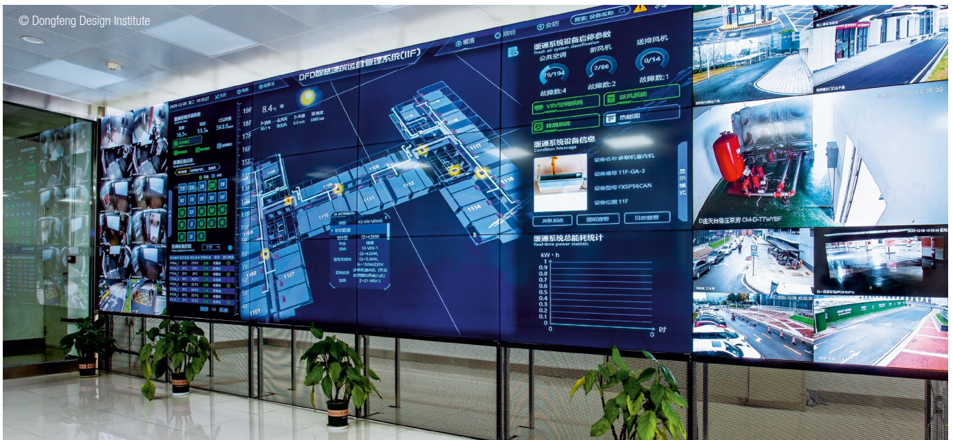
Das Gebäudemanagementsystem umfasst alle relevanten Teilsysteme. The building management system incorporates all relevant sub-systems.
